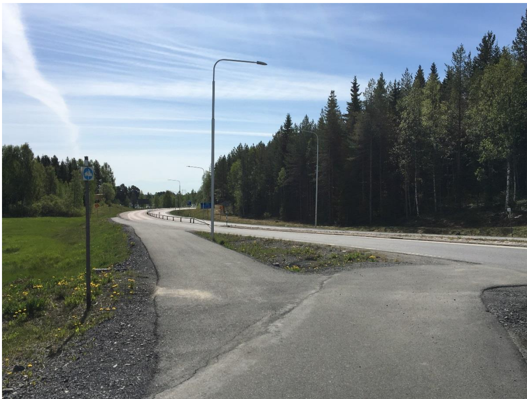
Figur 14: Förlängd gång- och cykelväg längs E14 österifrån mot cirkulationsplats på E14, tolkas i vissa fall av bilister som svängfält för motorfordon. Foto vid platsbesök 2018-05-24.
